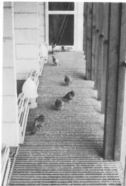
Rational pasning er kodeordet for Jos Thoné, hvor for alle slag er udstyret med gulvrister.
