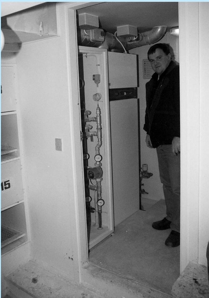
Leif i »Det lille teknikrum«, hvorfra udluftningen styres.
